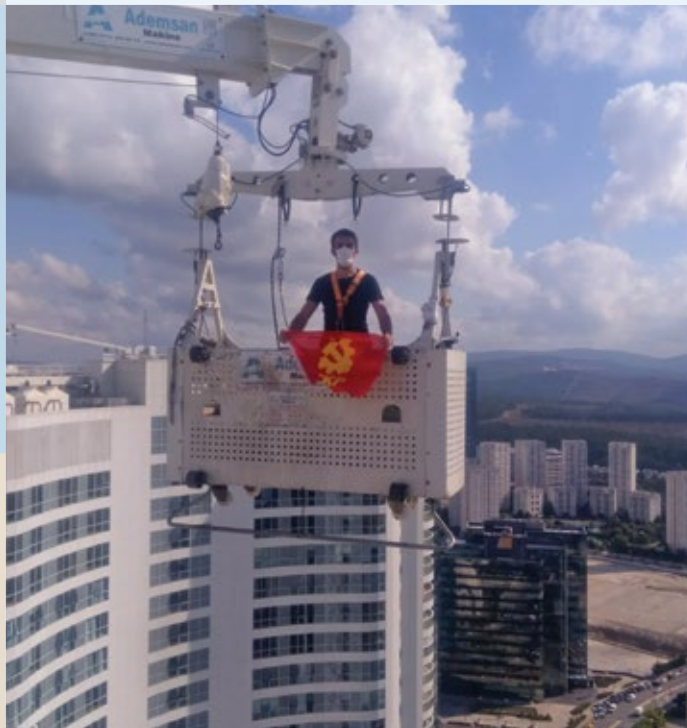
TKP'nin yüzüncü yaşı için yaptığı "500 noktada buluşalım" çağrısının yankı bulunduğu yerlerden biri de şantiyeler oldu.
